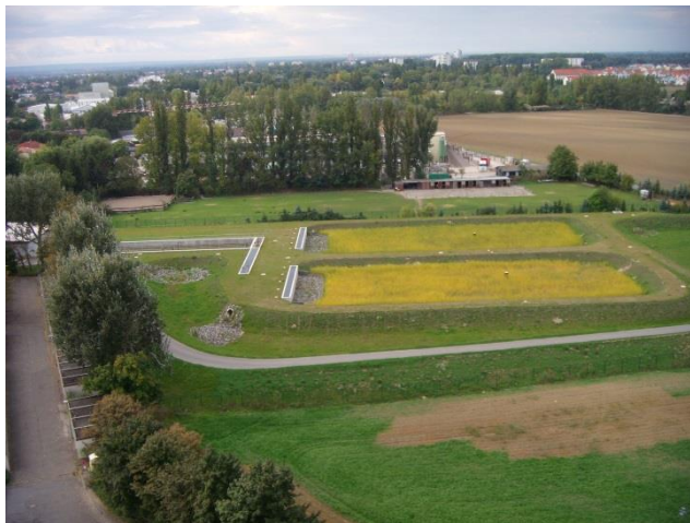
Regenwasseranlage Froschlache mit Retentionsfilterbecken
