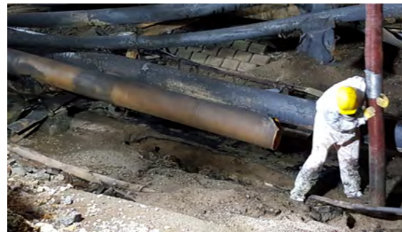
Absaugung des verunreinigten Bodens am Schadensort (Foto: Stadt Ludwigshafen, Bereich Umwelt)
