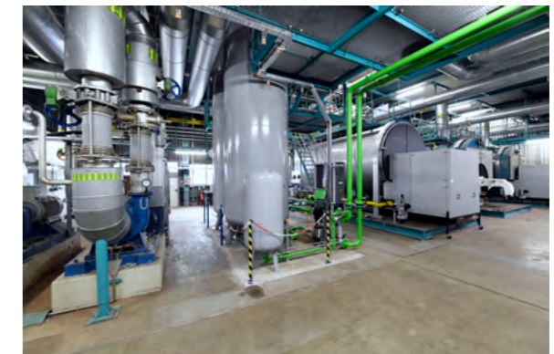
TWL-Heizwerk Pfingstweide (Foto: TWL, Fotograf: Thomas Henne)
