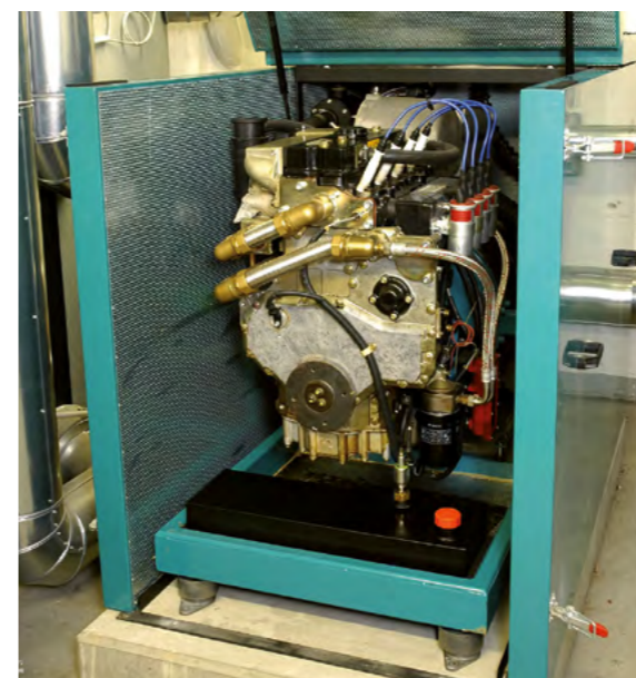
BHKW in der Albert-Einstein-Realschule plus beziehungsweise Rupprechtsschule (Foto: Stadt Ludwigshafen)
