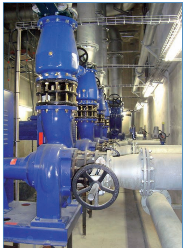
Wenn es wie aus Kübeln schüttet, im Einsatz: Regenwasserpumpen im Pumpwerk Froschlache
