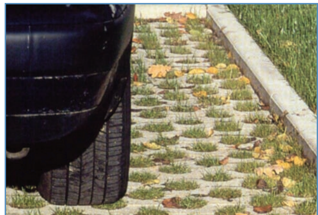
Hier kann Regenwasser versickern: wasserdurchlässiges Pflaster
