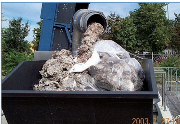
Was dem Wasser zugeführt wird, muss wieder herausgeholt werden: Container mit Rechengut
