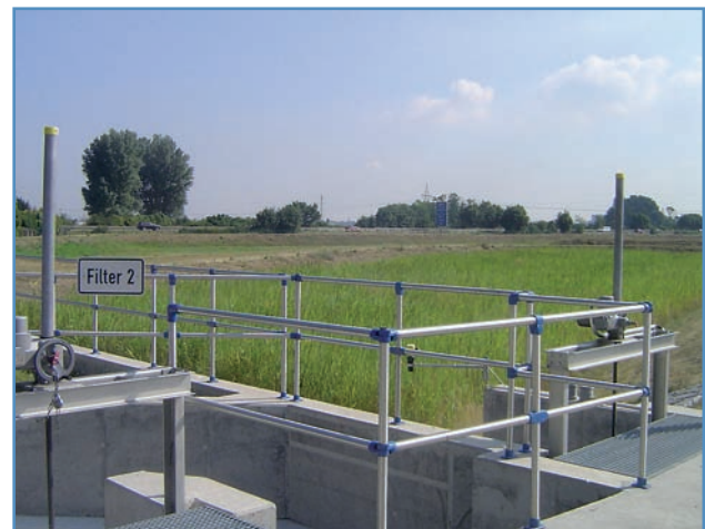
Retentionsbodenfilter in der Regenwasseranlage Ruchheim
