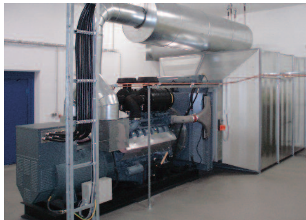
Notstromaggregat im Pumpwerk
