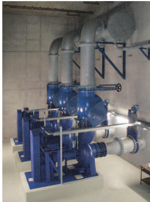
Hochwasserpumpen im Untergeschoss des Pumpwerks
