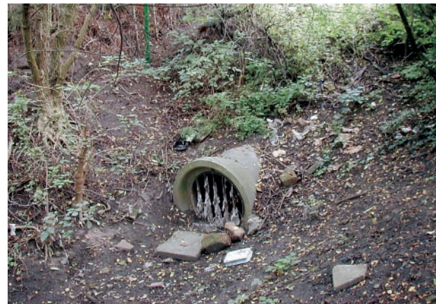
Mischwassereinleitestelle in den Brückweggraben
