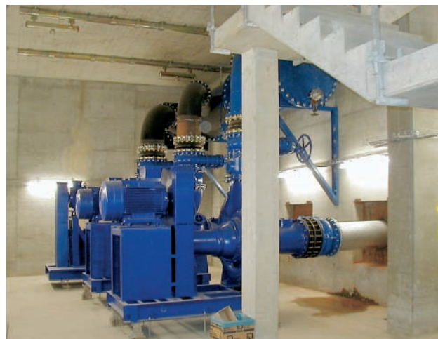
Regenwasserpumpen im Untergeschoss des Pumpwerks
